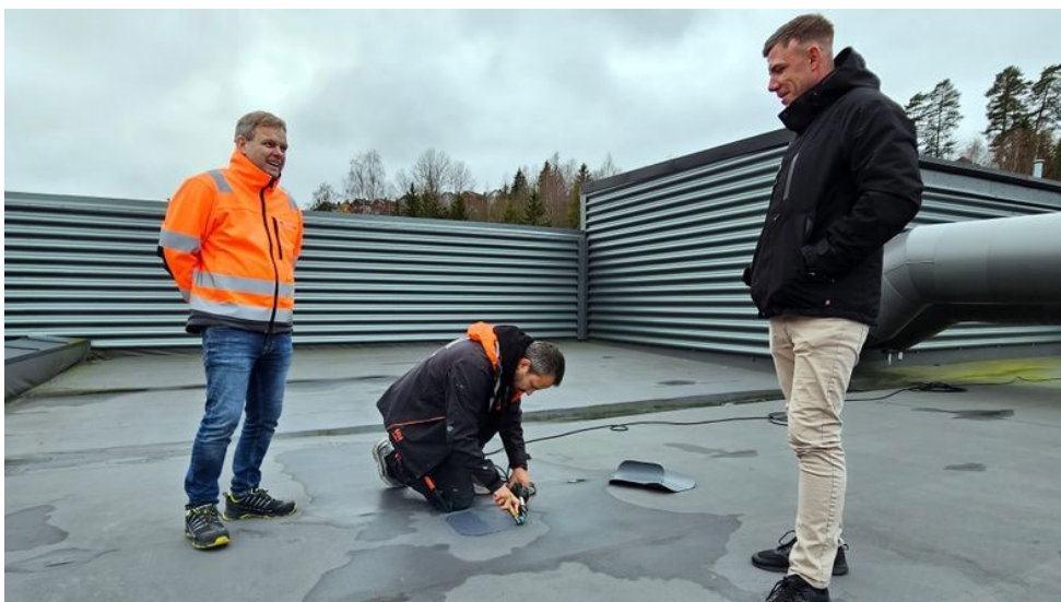
Morten Øien i Lett-Tak og Fredrik Rist i Inotek samarbeider om taksjekk og utbedring av avvik. Charles Reyes lapper et hull i takfolien. Foto: Knut Bjørheim
